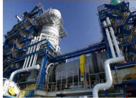
廃棄物発電施設
