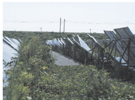
不十分な管理で放置されたパネル
