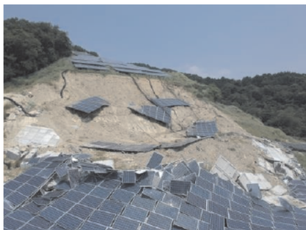
土砂崩れで生じた崩落
