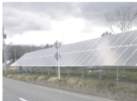
柵塀の設置されない設備
