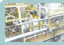
④高効率廃熱回収設備
