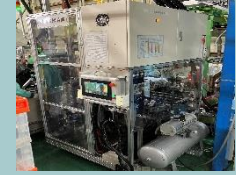
①プラスチックリユース設備
