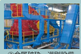
②金属破碎・選別設備
