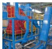
金属破碎・選別設備
