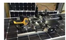
太陽光パネルのリサイクル設備
