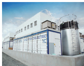
系統安定化のための蓄電池
