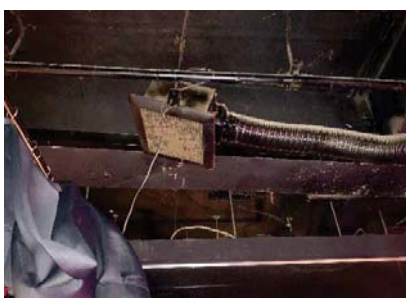
手入れをされていない換気扇
